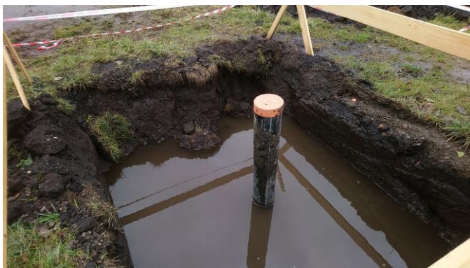
Obr. 4: Komplikace s hladinou podz. vody
